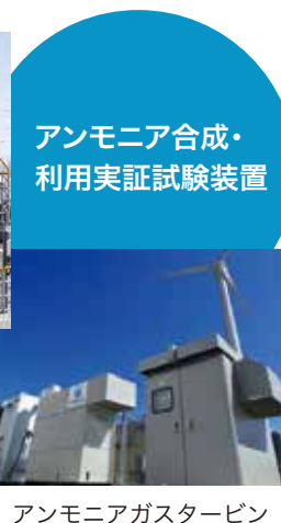
アンモニアガスタービン
