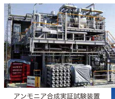
アンモニア合成実証試験装置
